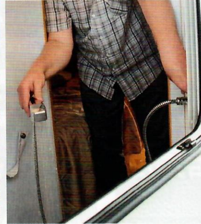
Gespült werden alle Leitungen, also auch den Wasserhahn und die Duscharmatur im Bad aufdrehen. Fünf Minuten zwischen den einminütigen Spülvorgängen genügen.
