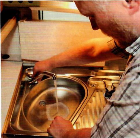
Ist der Tank mit dem Wasser-Desinfektionsgemisch zur Erstentkeimung befüllt, wird das Leitungssystem drei Mal je eine Minute lang gespült. Bei kleinen Tanks ist Nachfüllen nötig.
